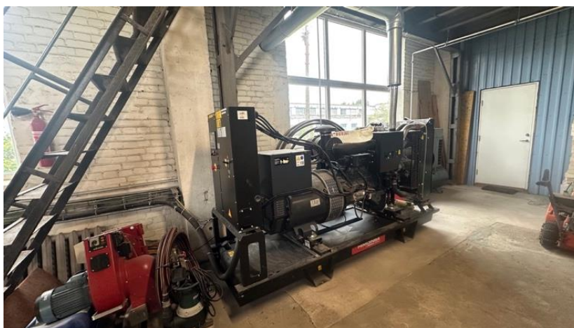
Joonis 7. Kuusalu katlamaja varu elektrigeneraator
